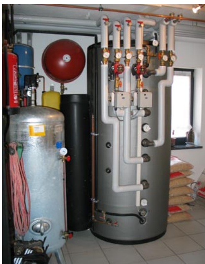
1.000 Liter Pufferspeicher für Heizungs und Warmwasser.
